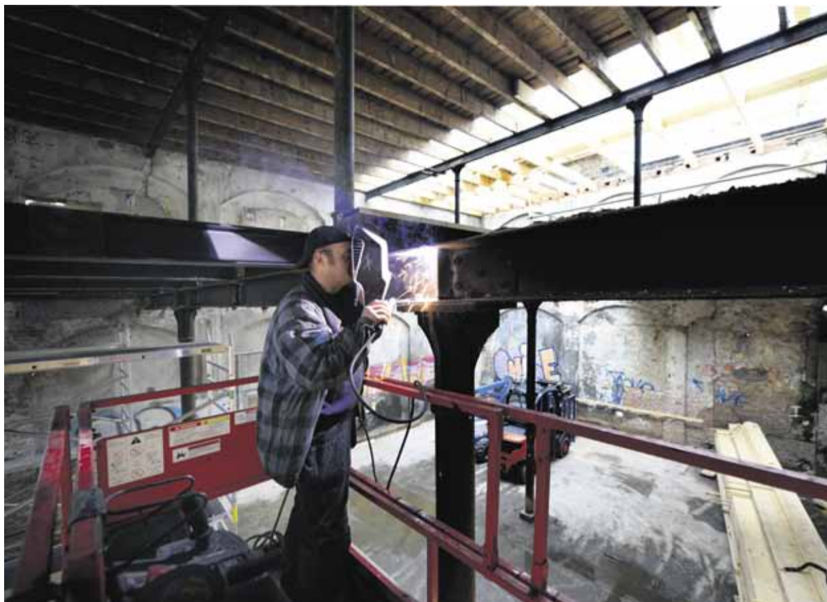
In de Utrechtse wijk Oog in Al is bouw- en restauratiebedrijf Van de Burgt & Strooij begonnen met de cascorestauratie van de Stichtse Olie- en Lijnkoekenfabriek. In opdracht van Boei uit Amersfoort wordt dit zogeheten Cereol-complex uit 1905 omgebouwd tot nieuwbouwcomplex Meyster's Buiten.
